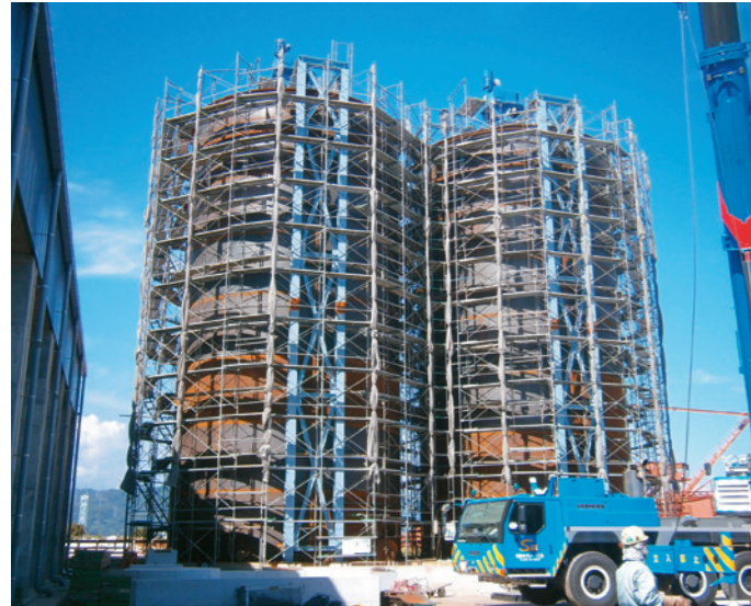
1,000m 3 ストレージタンク [9,100 φ ×18,000 H ] 2基
