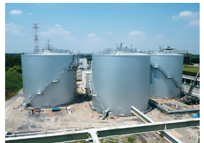
5,000m 3 消化槽 [20,000 φ ×18,000 H ] 3基
