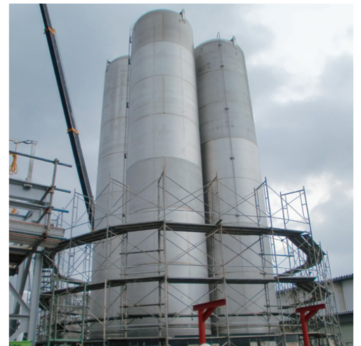
150 KL LNG貯槽 [3,400 φ ×(15,400+2,000) H ] 4基
