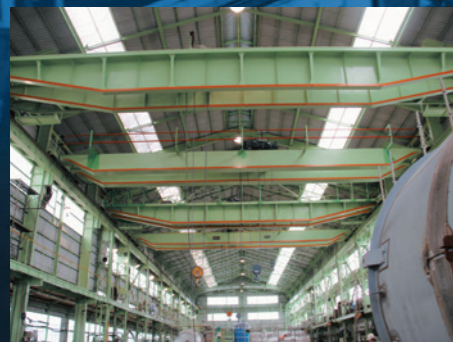
天井走行クレーン
