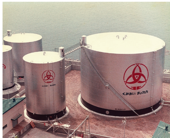
重油タンク [5,000 KL 1基、1,000 KL 1基]
