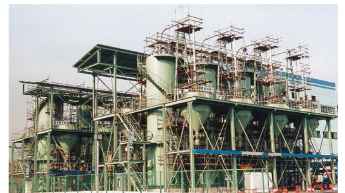
活性炭吸着塔 [3,200 φ ×14,200 H 4基 他8基]
