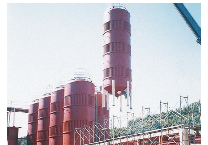
120 KL 屋外タンク [3,750 φ ×11,000 H 8基]
