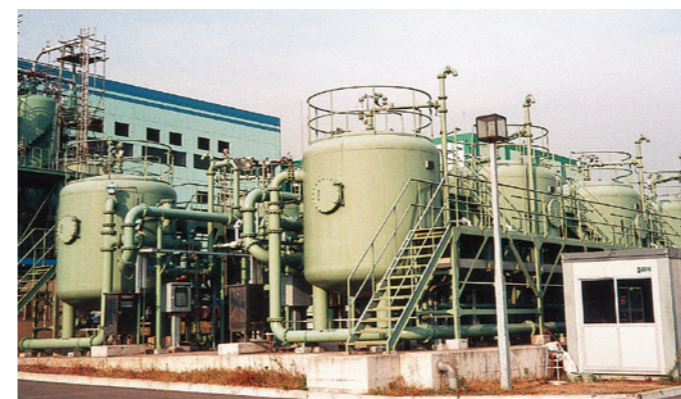
砂ろ過器 [3,500 φ ×3,500 H 8基]
