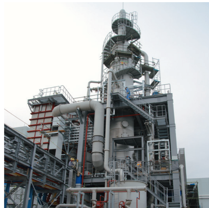
排煙処理塔他 [2,750 φ ×24,510 H ]
