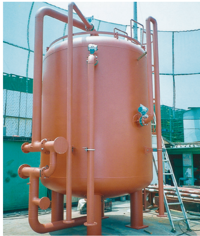
圧力ろ過器 [25m 3 6基]
