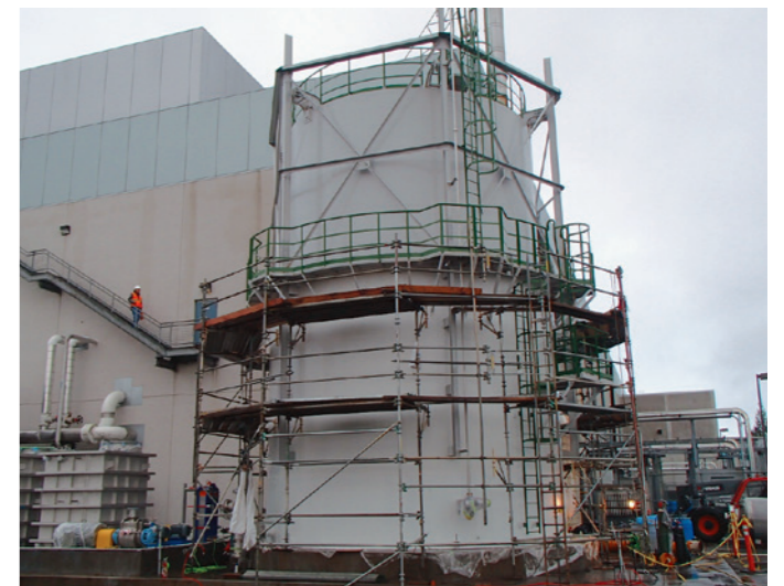
アメリカ現地据付 200m 3 有水式ガスホルダー
