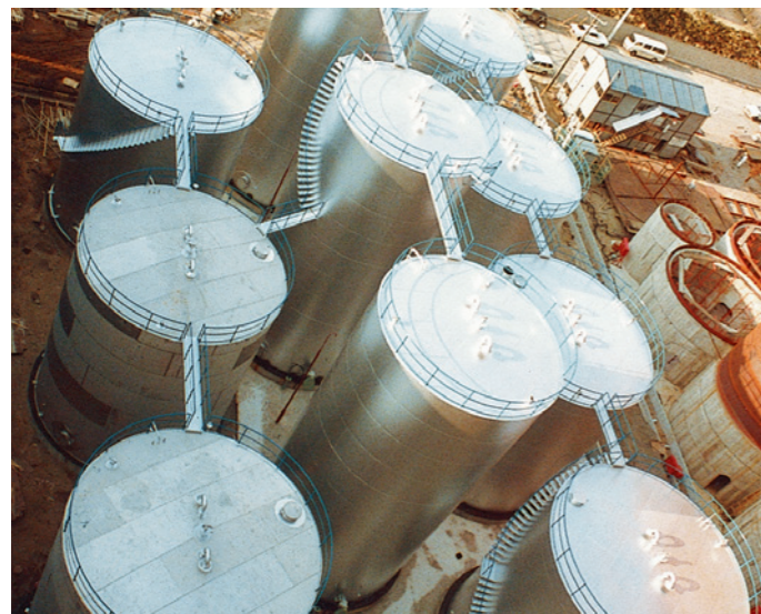
動植物油タンク [750 KL 10基]
