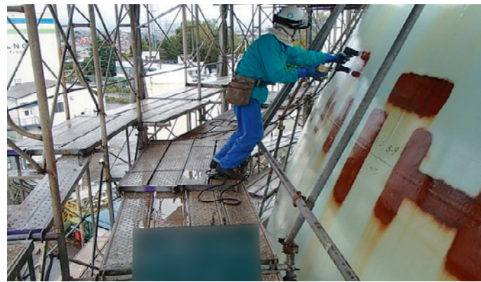
外部MT検査
