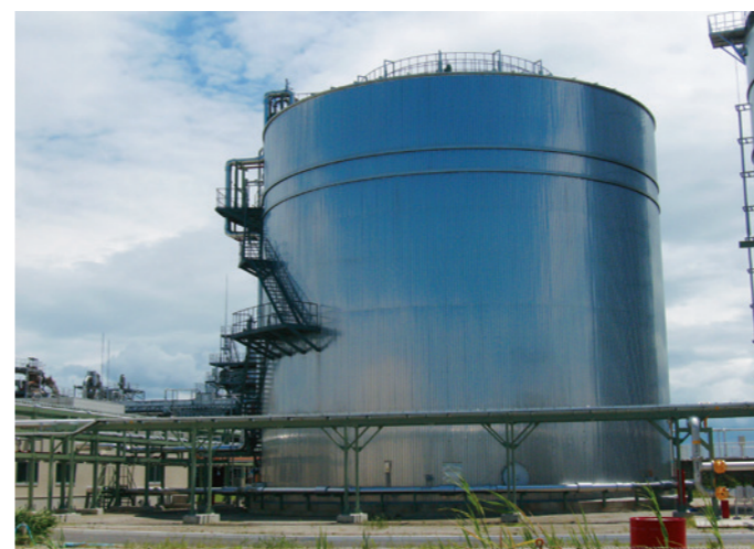
5,800m 3 鋼板製消化タンク [21,000 φ ×18,650 H ]
