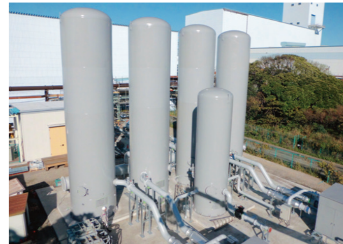
80m 3 ミキシングタンク [3,000 φ ×10,900 H +スカート1,600 H 5基]
